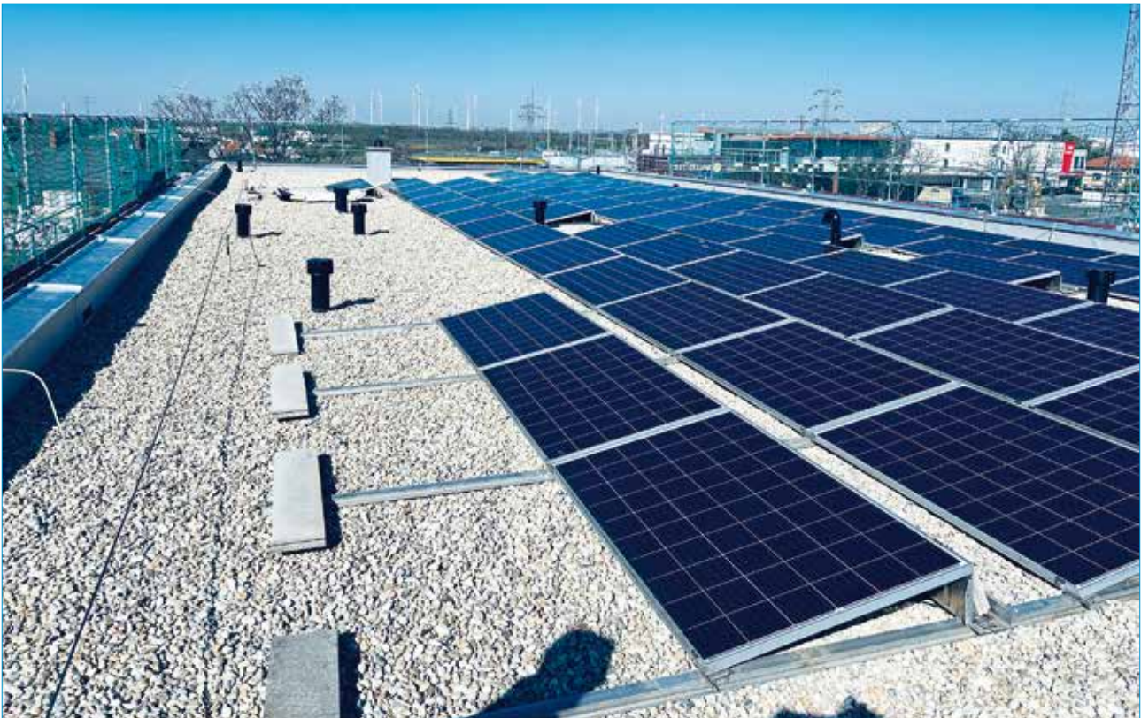
Auf dem Dach des WLV-Standorts Neusiedl am See sorgt eine Photovoltaikanlage für sauberen Sonnenstrom.
